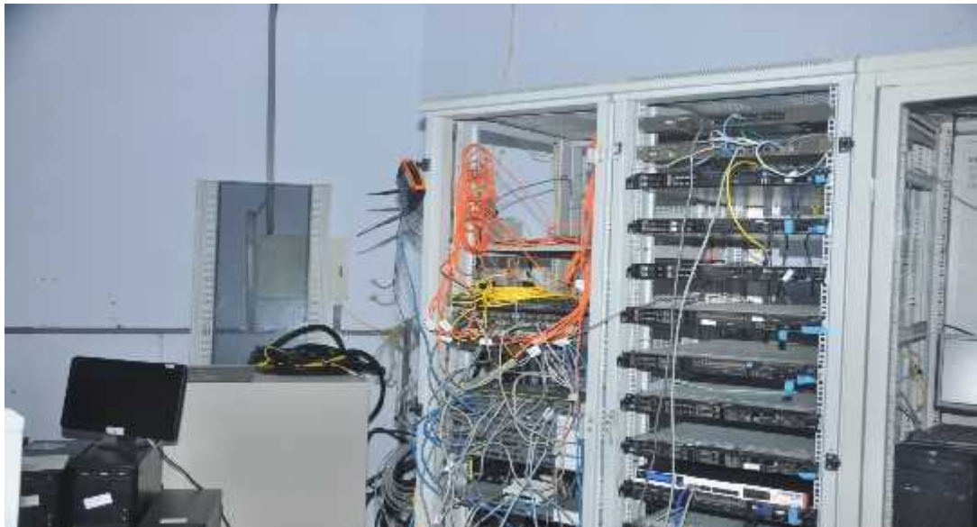
Gambar 4.5. Ruang Server UPT TIK UHO
